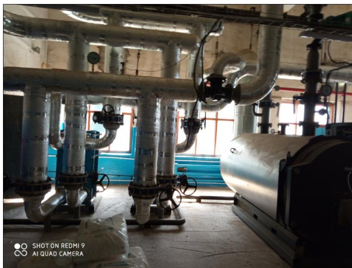
Газовая котельная после реконструкции
